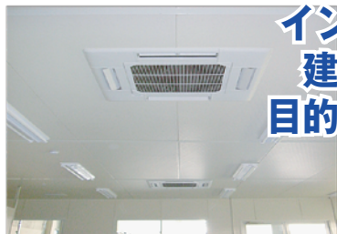
天井パネル&照明器具
